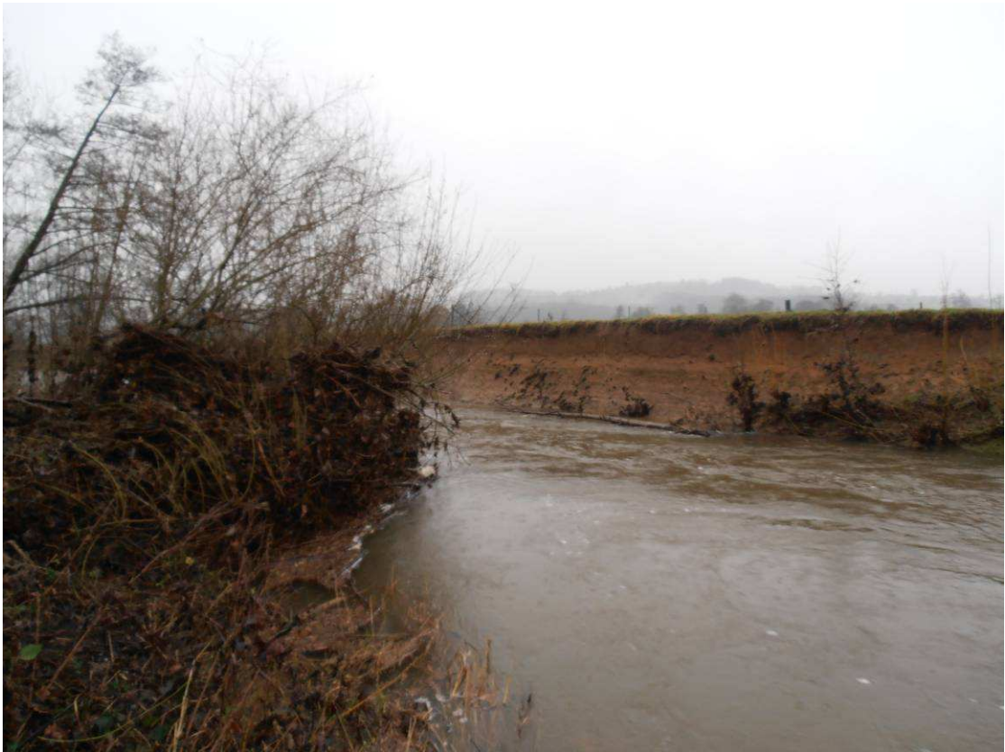
Végétation buissonnante fortement développée à l'intérieur du méandre créant un déflecteur et accélérant l'érosion de la berge opposée.
