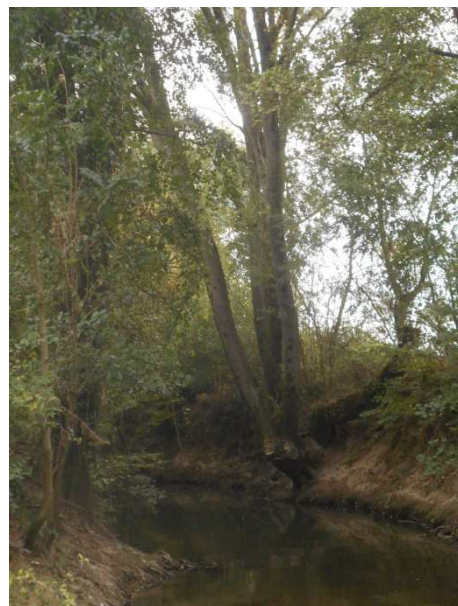
Cépée d'arborescents initialement implantée en haut de berge ayant glissé en pied de berge et pouvant prochainement être source d'encombre. A recouper
