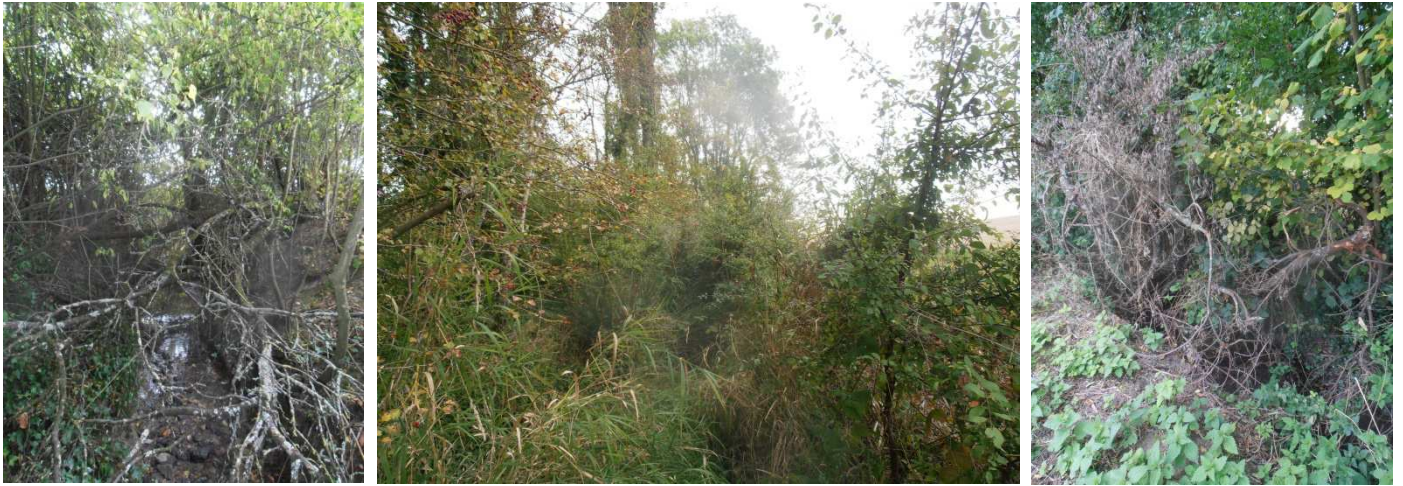
Observation d'une végétation arbustive recouvrant fortement le lit du ruisseau, limitant par conséquent les écoulements. Réalisation d'un aspect voûte dans la végétation située sur chaque rive.
