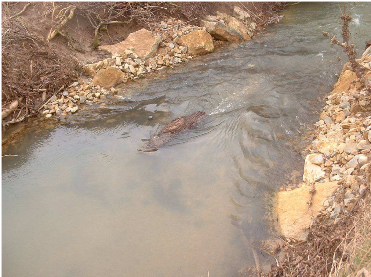
Vue après les crues de l'Hiver 2008-2009 : A noter le dépôt de gravier à l'amont du seuil
