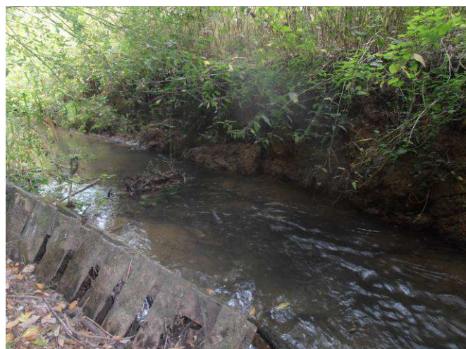
Observation d'encoche d'érosion régressive. Création d'un radier pour freiner l'effet d'érosion.
