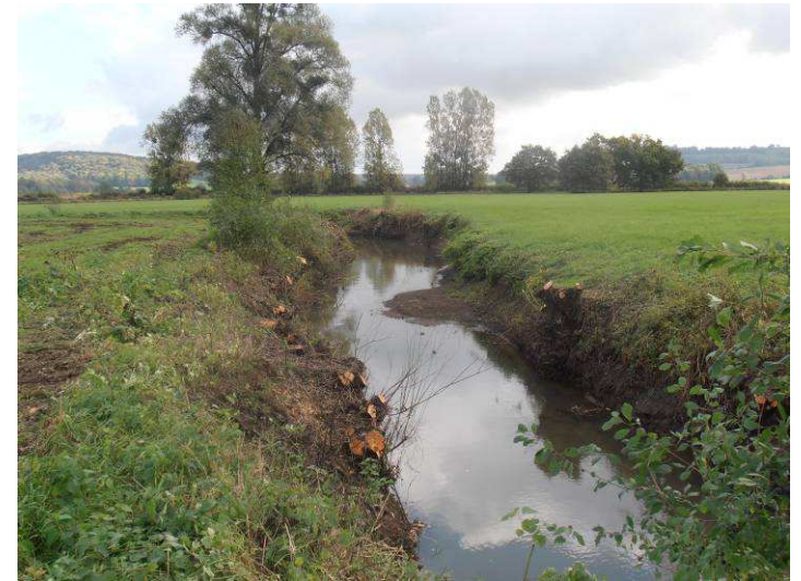
Après : Coupe et extraction des saules buissonnants fortement développés en installés sur la berge.
