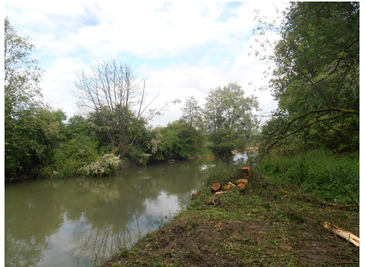
Coupe des saules et aulnes inclinés sur la rivière afin de ne plus limiter aux écoulements.
