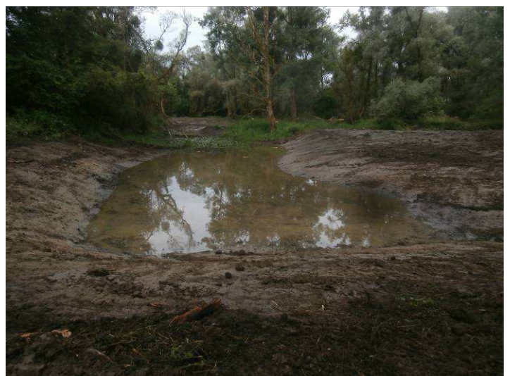
Extraction du buissonnant et augmentation de la surface de contact de l'eau et création de berge en pente douce sur la partie amont de l'annexe.
