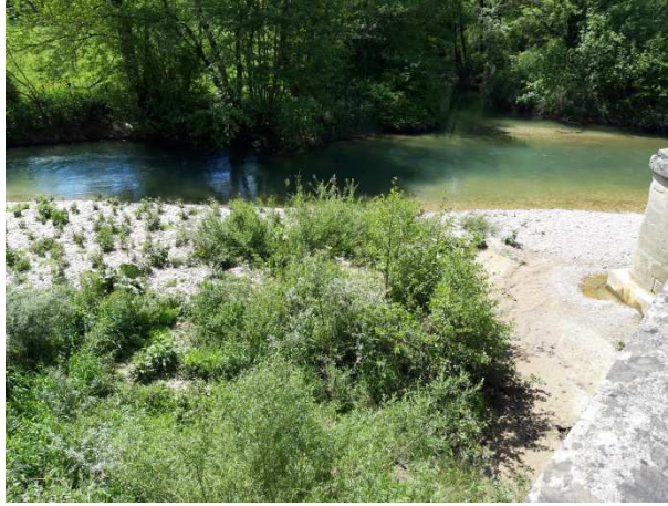
Vue amont de l'atterrissement avec emprise sur l'arche droite et la majeure partie de l'arche centrale.
