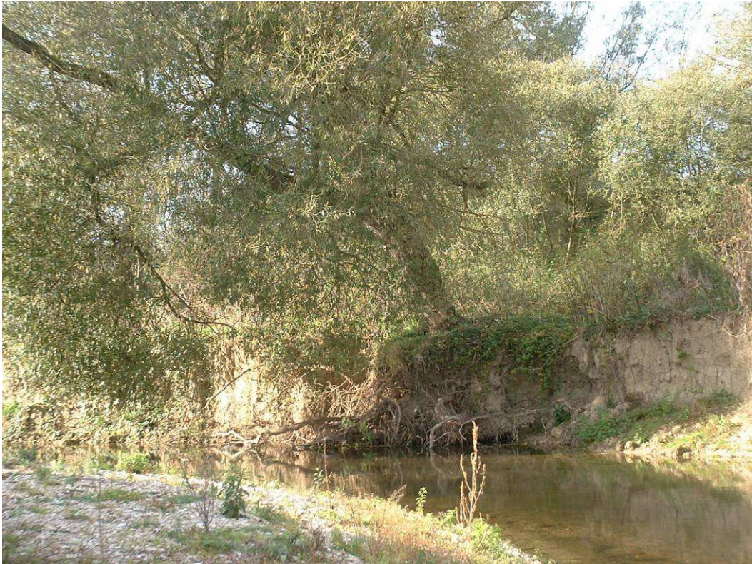
Erosion de berge : saule menacé, en cas de déracinement la souche se stabilisera en pied de berge
