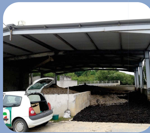
Impossible de séparer les lots de boues sur ce hangar de stockage d'une station d'épuration urbaine :
